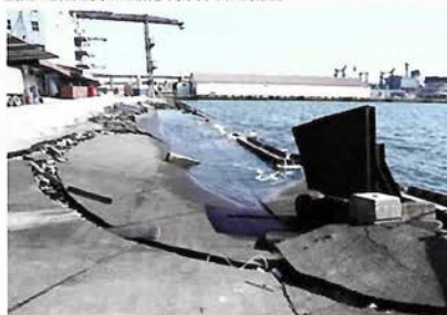
震災の被害を受けた新港(写真:大木本美通)
