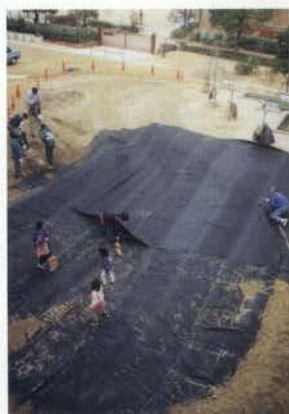
三ツ星ベルトのスタッフたちによって遮水シートを敷設する
