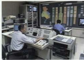
ネットワーク管理室 防災システムや衛生通信ネットワークの心臓部であるサーバ等の情報通信機器を守るため、免震床を採用
