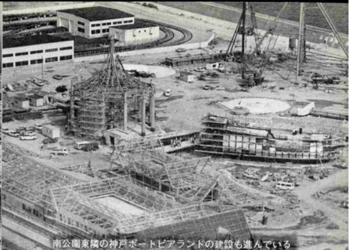
南公園東隣の神戸ポートピアランドの建設も進んでいる
